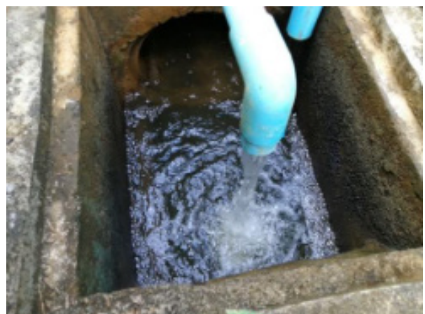
รูปที่ 11 น้ำทิ้งจากระบบ RO ปริมาณมากถูกปล่อยทิ้งระบบบำบัดน้ำเสีย (ก่อนการปรับปรุง)
