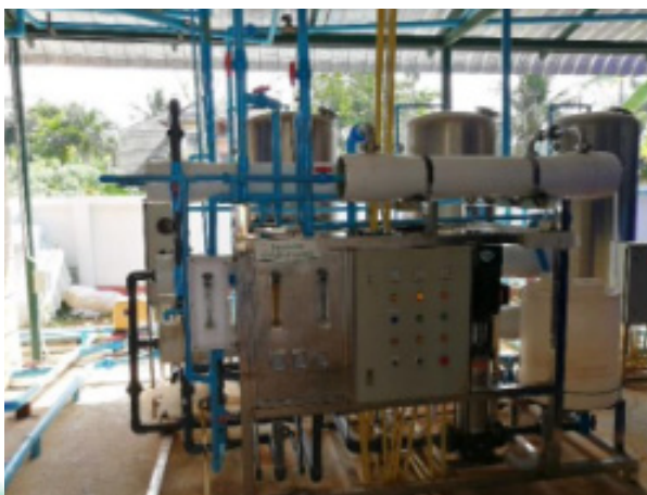
รูปที่ 10 การปรับปรุงคุณภาพน้ำด้วยระบบ RO (ก่อนการปรับปรุง)
